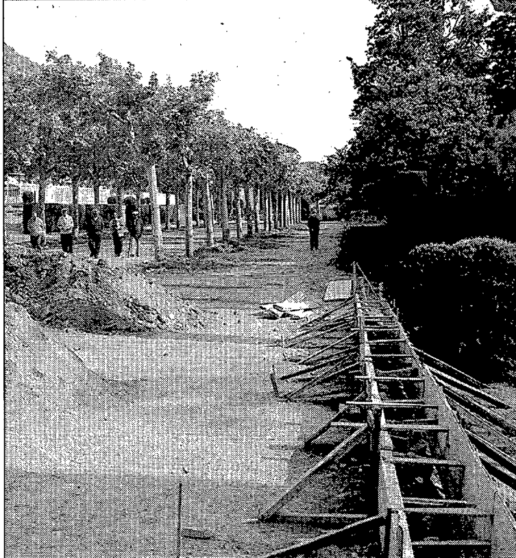
Obres al passeig del parc. Els treballs han de quedar enllestits aquest mes
