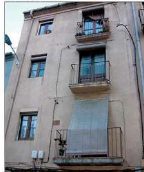
Façana de l'edifici sinistrat
